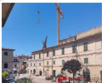
CAMERANO - E' successo nelle prime ore del pomeriggio. Sul posto sono intervenuti vigili del fuoco e carabinieri... 29 Giugno 2023 / Cronaca
